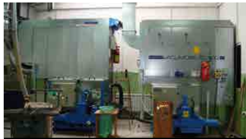
Vacuumobil EA 300 oraz JP 300 w pomieszczeniu hali produkcyjnej.
