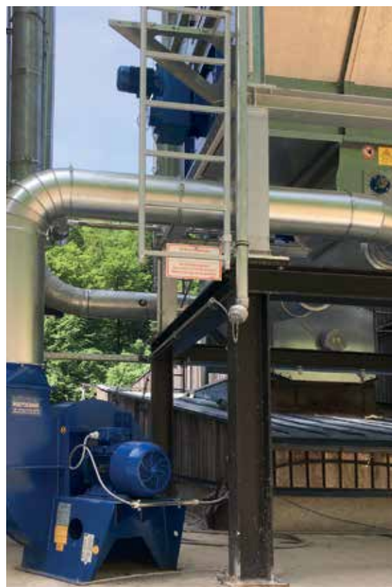
Połączenie przenośnika ślimakowego i śluzy celkowej pomaga w odprowadzaniu dużej ilości wiórów odseparowanych w filtrze. Powstający w ten sposób materiał reszkowy jest transportowany do silosu na wióry i trociny za pomocą wentylatora transportowego. Fot. Höcker Polytechnik
