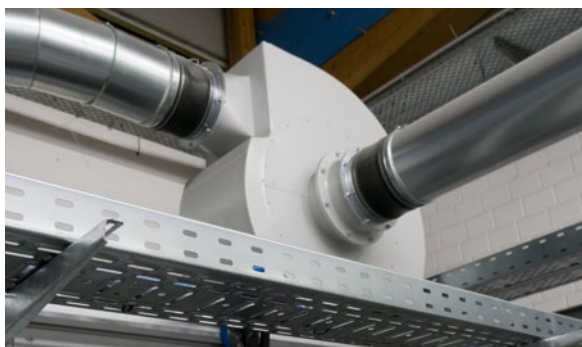
Wentylator transportowy w zastosowaniu
